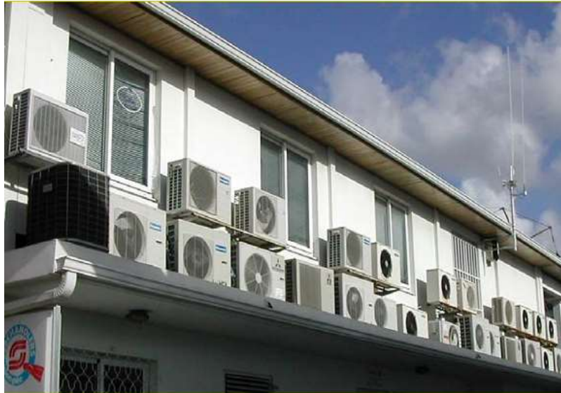
Figura 58: Impianti singoli di tipo split in un edificio
