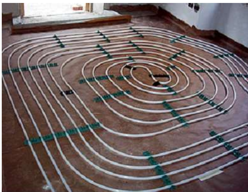
Figura 109: Pannelli radianti a pavimento
