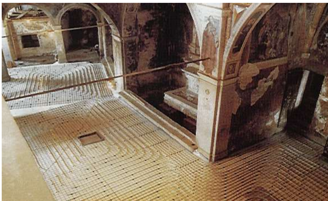
Figura 316: esempio di applicazione dei pannelli radianti in una chiesa
