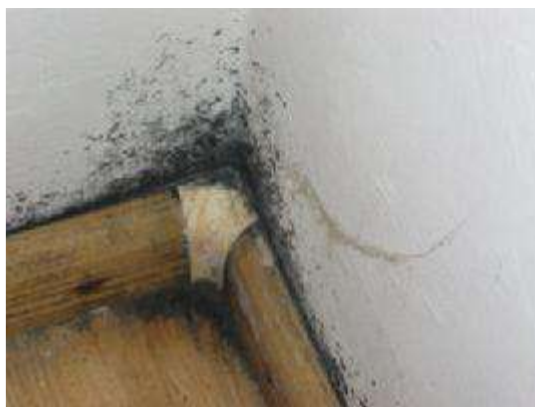
Figura 9: Formazione di condensa e muffa in corrispondenza dell'intersezione di due pareti
